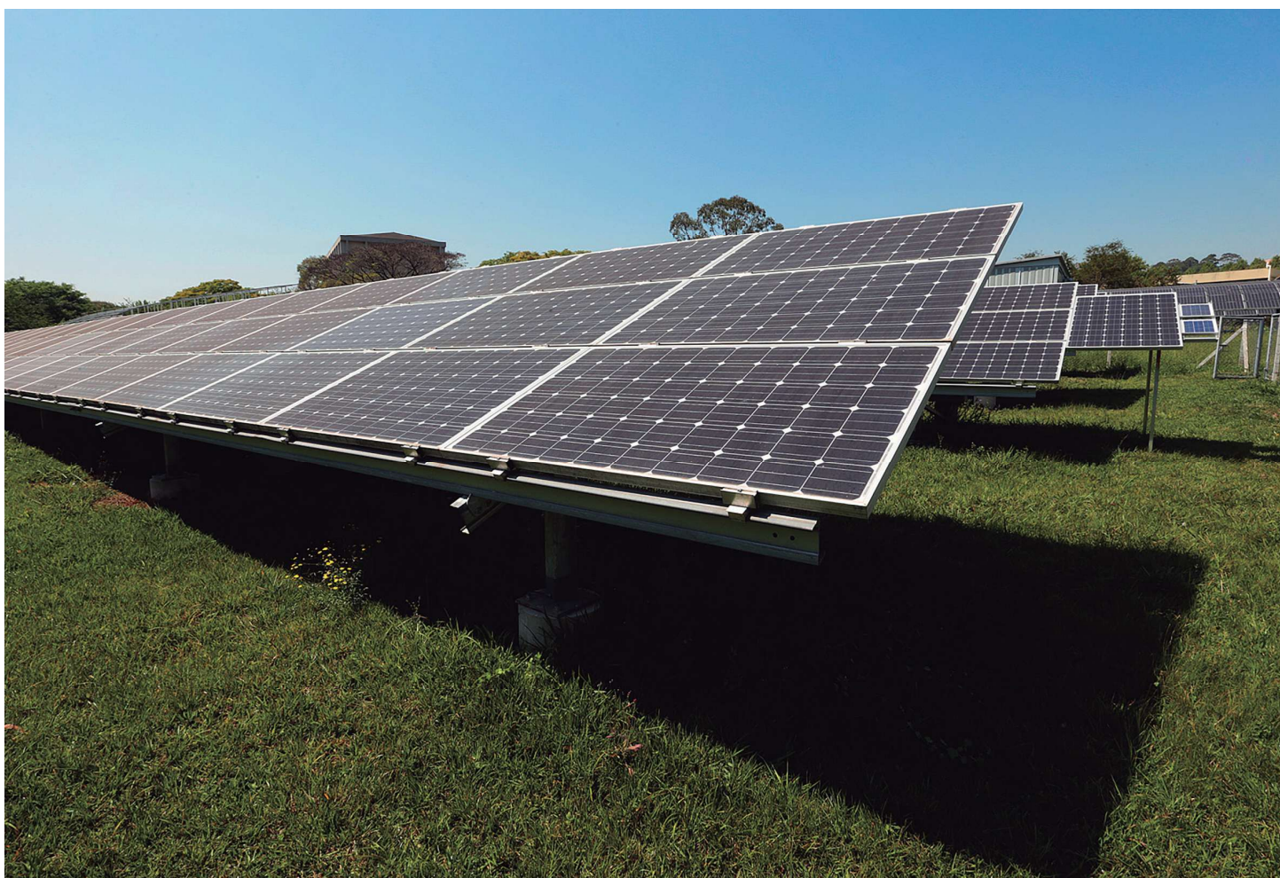
USINA SOLAR FOTOVOLTAICA DE 540 KW DO INSTITUTO DE ENERGIA E AMBIENTE, NA CIDADE UNIVERSITÁRIA FOTO: MARCOS SANTOS/USP IMAGENS
