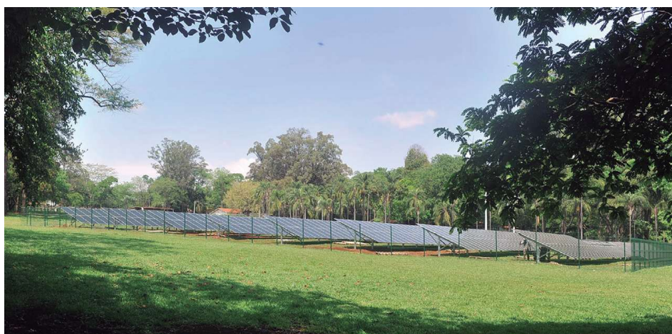
USINA SOLAR FOTOVOLTAICA NO CAMPUS DE RIBEIRÃO PRETO FOTO: VLADIMIR TASCA
