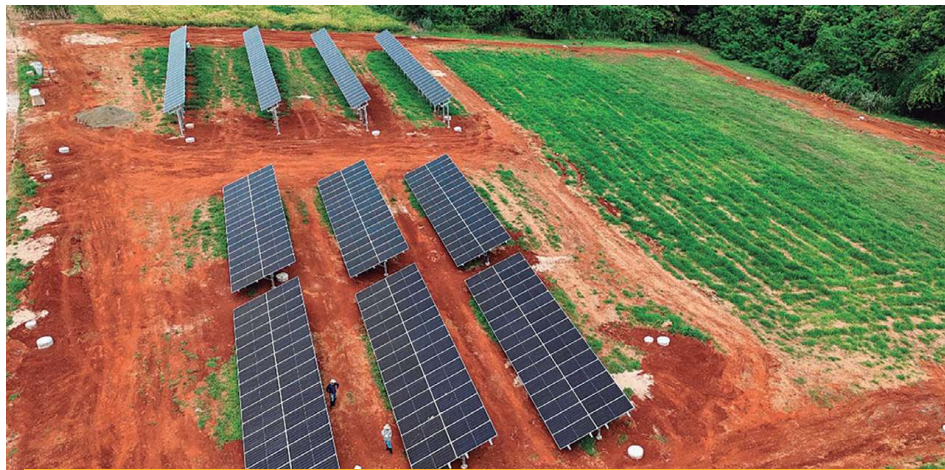
VISTA DO SISTEMA AGRIVOLTAICO EM IMPLEMENTAÇÃO NO CAMPUS DE PIRACICABA FOTO: DIVULGAÇÃO
